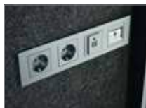
Anschlüsse in der Kabine
